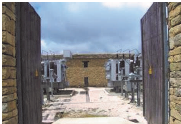
Entrada al parque de intemperie de Alaiz.
