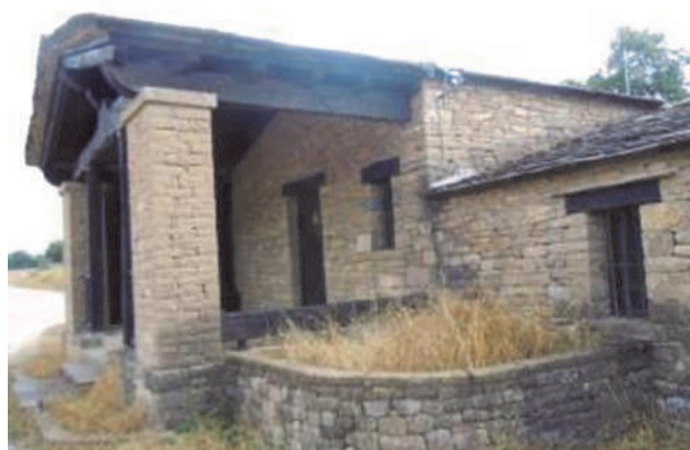
Entrada al edificio de la subestación de Ibargoiti.
