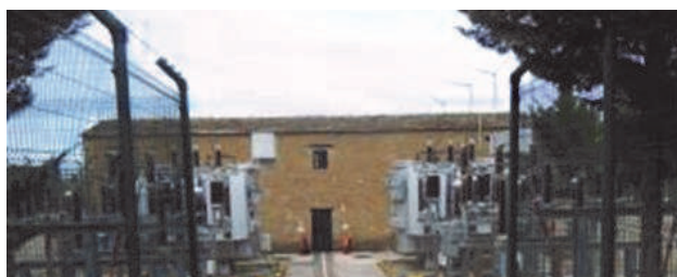
Parque de intemperie de la subestación de Izco.
