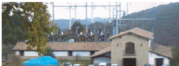
Vista general de la subestación de Codés.
