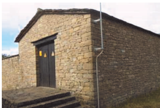
Exterior del edificio de cuadros eléctricos en Ibargoiti.
