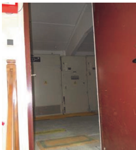
Interior del recinto de armarios de la subestación de Alaiz, con paredes y cubierta de hormigón
