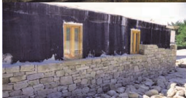
Construcción de la subestación con muros y cubiertas de hormigón, forrados de piedra de bordas, en la subestación de Ibargoiti.
