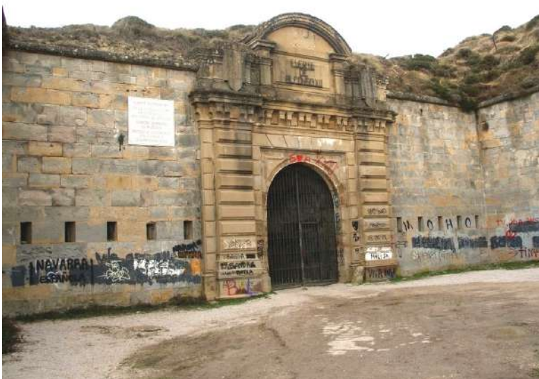
Estado del acceso principal antes de su limpieza y restauración en 2020.
