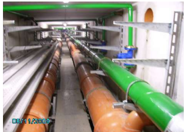
Canalizaciones en las galerías
